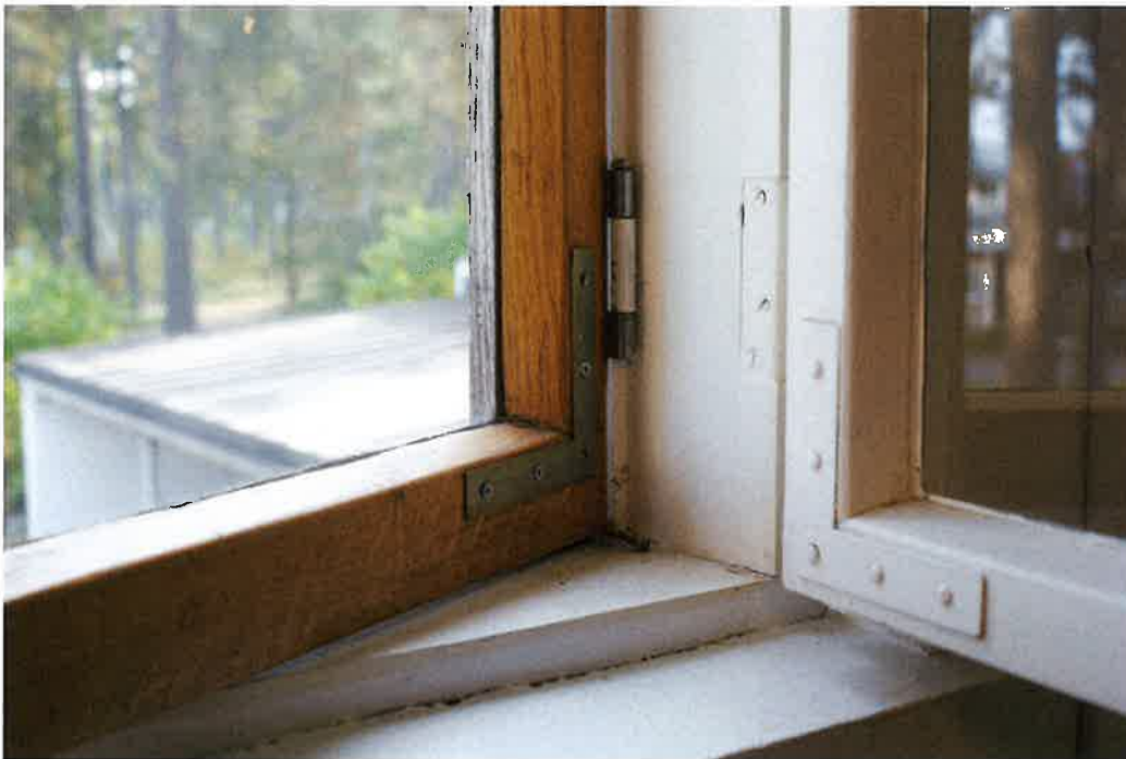
Samat rakenteet ja detaljit toistuvat kaikissa ikkunoissa. Tässä F104.4. Ikkunat F104 ovat sopivan kokoisia tuuletukseen, ja niissä onkin kiintopainike.
